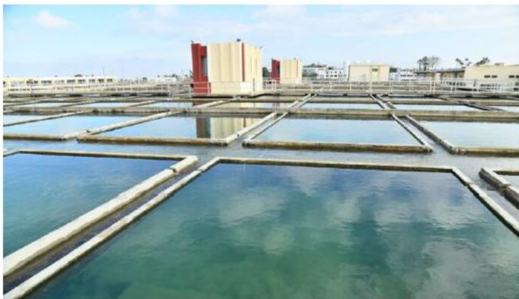
Station de traitement des eaux du Bouregreg de l'ONEE. Crédit: Rachid Thiouni
