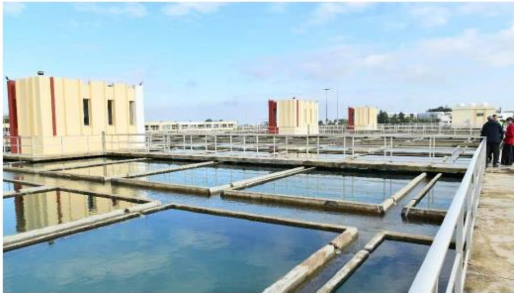
Station de traitement des eaux du Bouregreg de l'ONEE. Crédit: Rachid Tniouni
